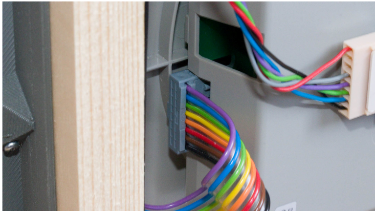
Figuur 15: Aansluiting bandkabel op draaischijf
